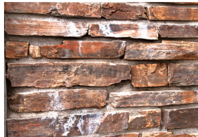
(壁) 従来のエフロカット材混入の場合 (施工 4 ヶ月後)
