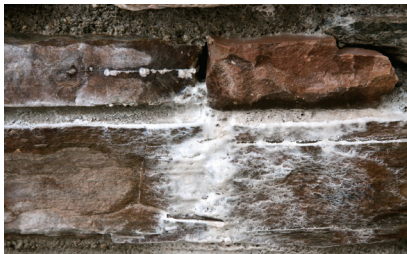
従来技術（1：3モルタル）で施工した壁 施工5日後に白華を確認
