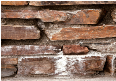
(壁) 従来セメントの場合 (施工 6 ヶ月後)
