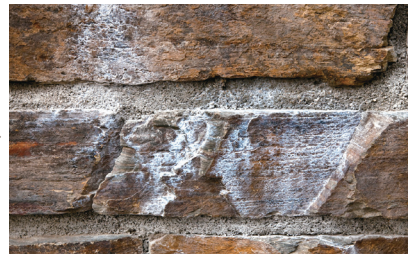
既存のエフロカット材を使用した壁 施工10日後に白華を確認
