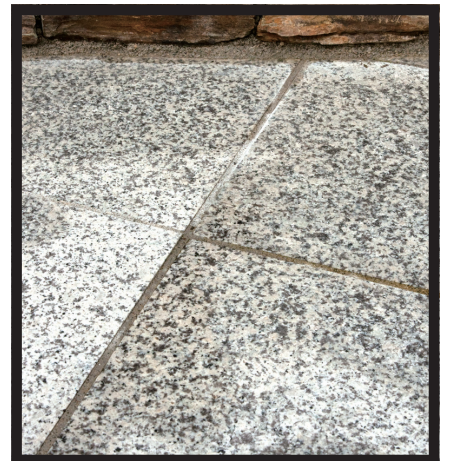
(床) つげセメント の場合 (施工 6 ヶ月後)
